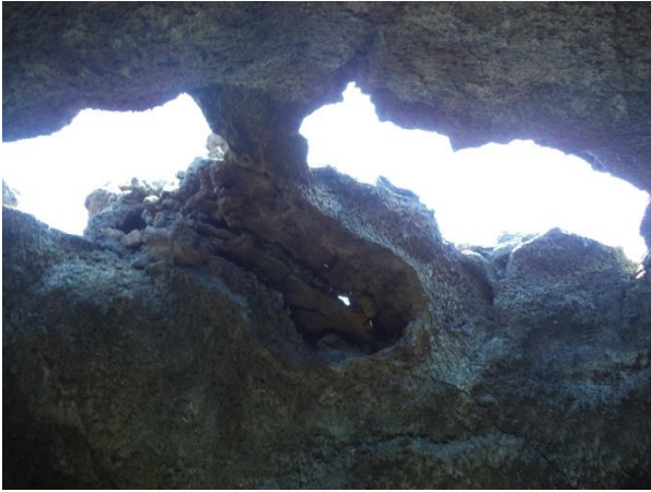
Volta crollata della grotta dei lamponi
